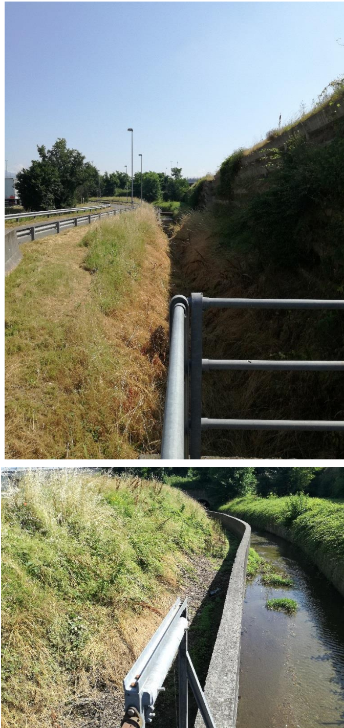
Figura 16 – Fosso irriguo privato esistente tra la tangenziale Sud e l'attraversamento autostradale esistente – tratti oggetto di adeguamento (nuova canaletta di progetto)
