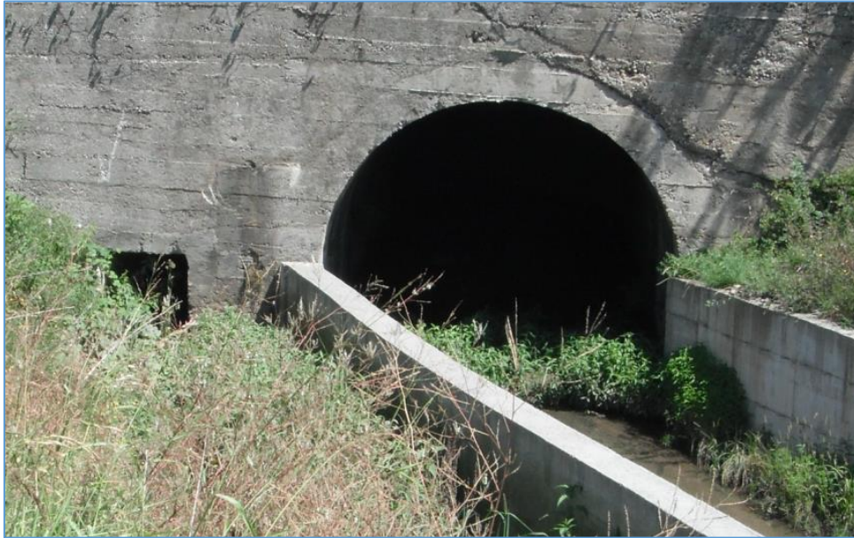
Figura 15– Manufatti esistenti della Roggia Colleonesca e del fosso irriguo privato, oggetto di prolungamenti
