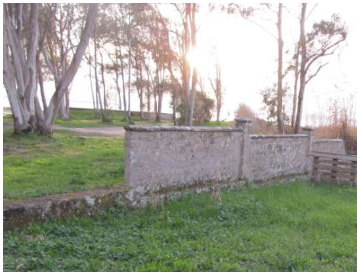
Muretto storico da consolidare e da valorizzare
