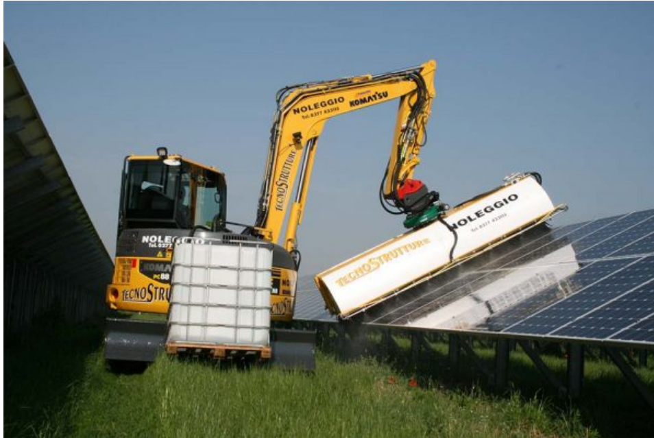
Sistema automatizzato lavaggio moduli fotovoltaici
