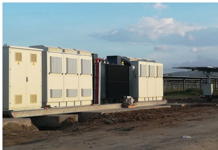
Figura 10 Esempio skid conversione
