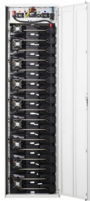
Figura 12 - Esempio rack batterie
