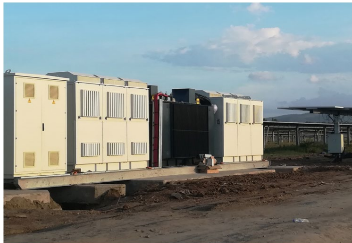
Figura 16 - Esempio skid conversione
