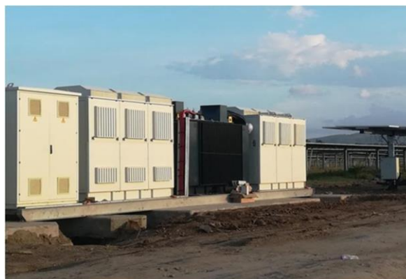
Esempio skid conversione
