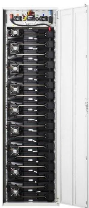
Esempio rack batterie
