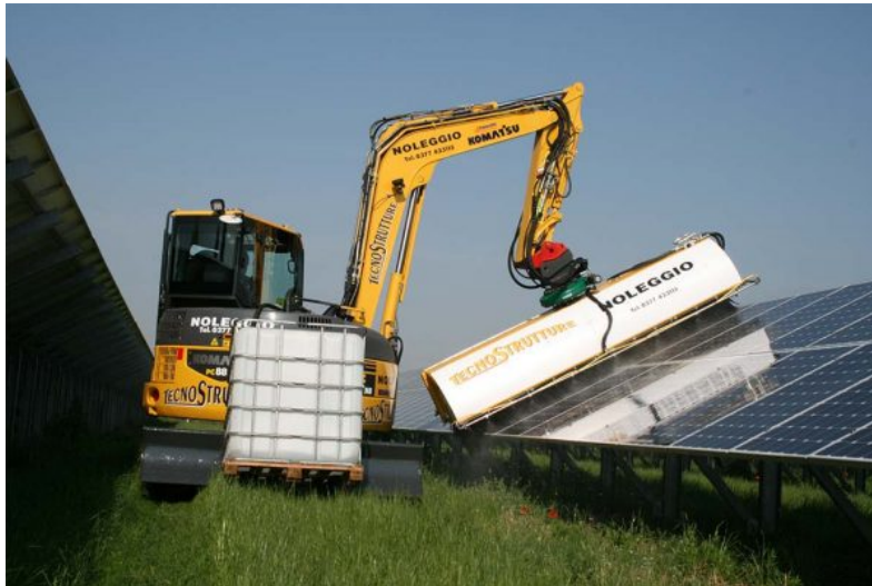
Sistema automatizzato lavaggio moduli fotovoltaici
