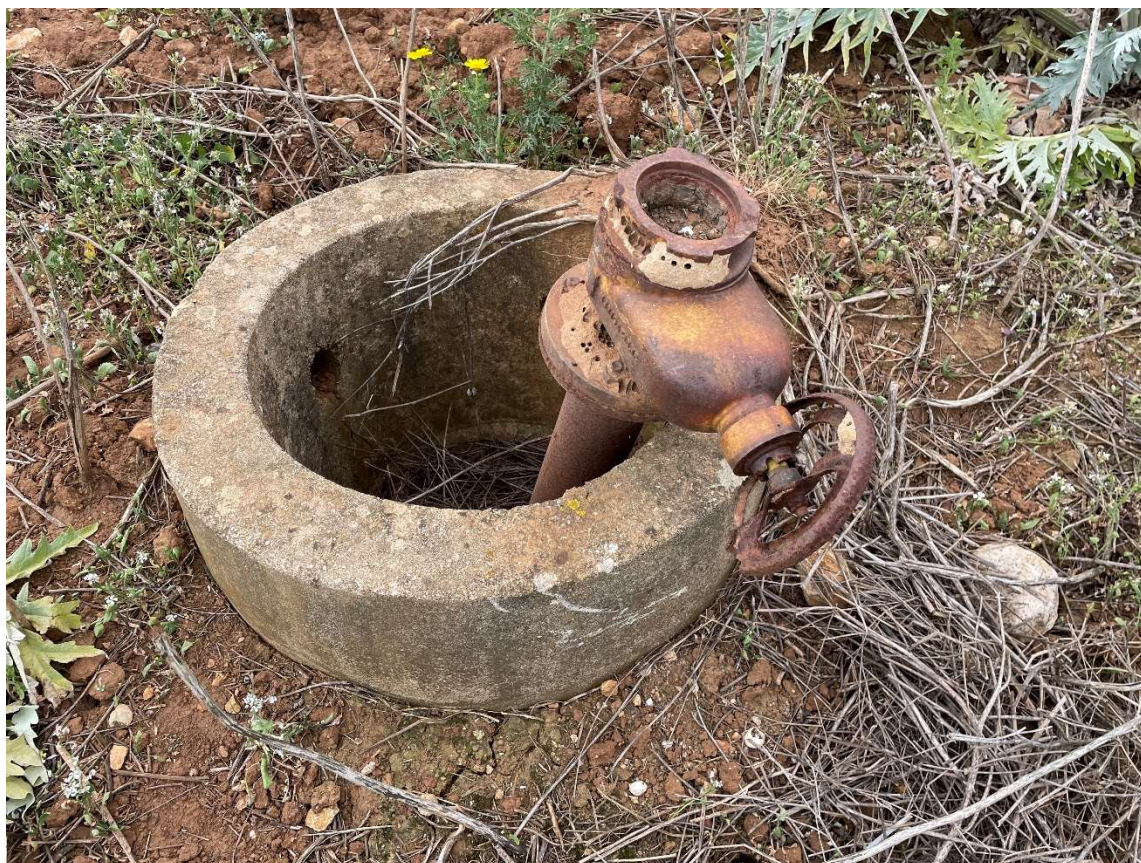
Foto 5 particolare idrante Consorzio di bonifica
