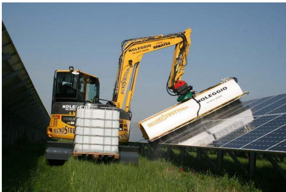
Sistema automatizzato lavaggio moduli fotovoltaici
