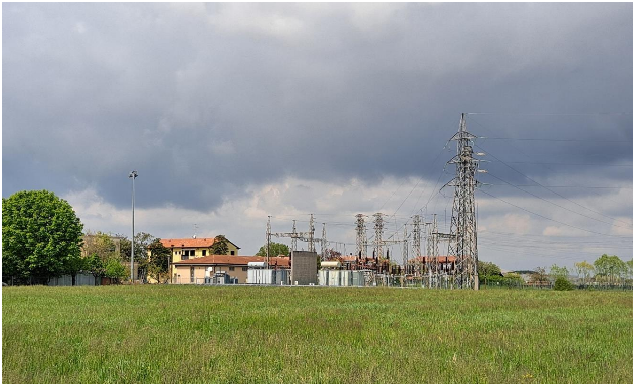
Figura 3-11 - Cabina primaria AT/MT "Levada"
