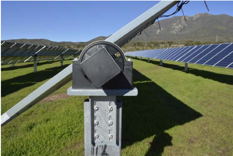
Figura 27 dettaglio del tracker ad inseguimento
