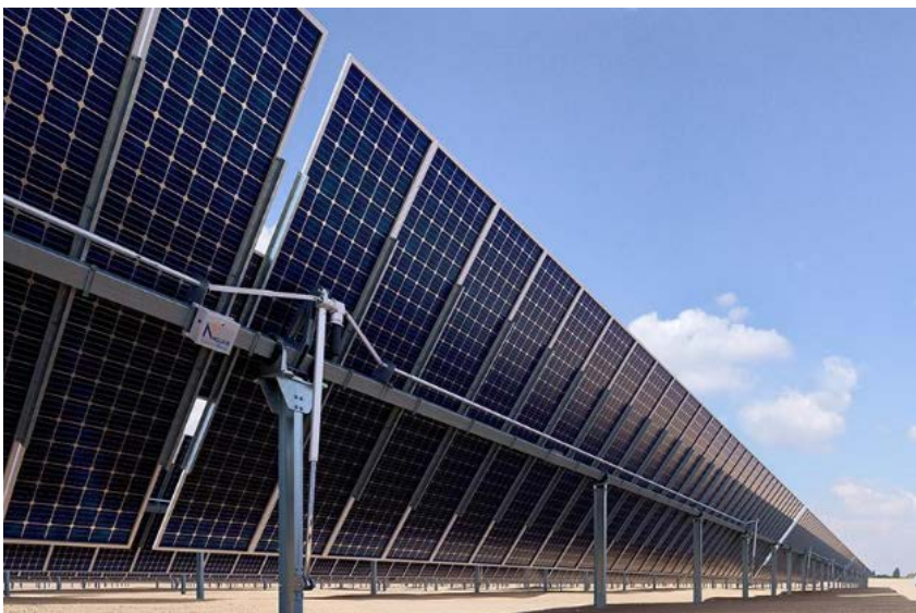
Figura 28 dettaglio del tracker ad inseguimento
