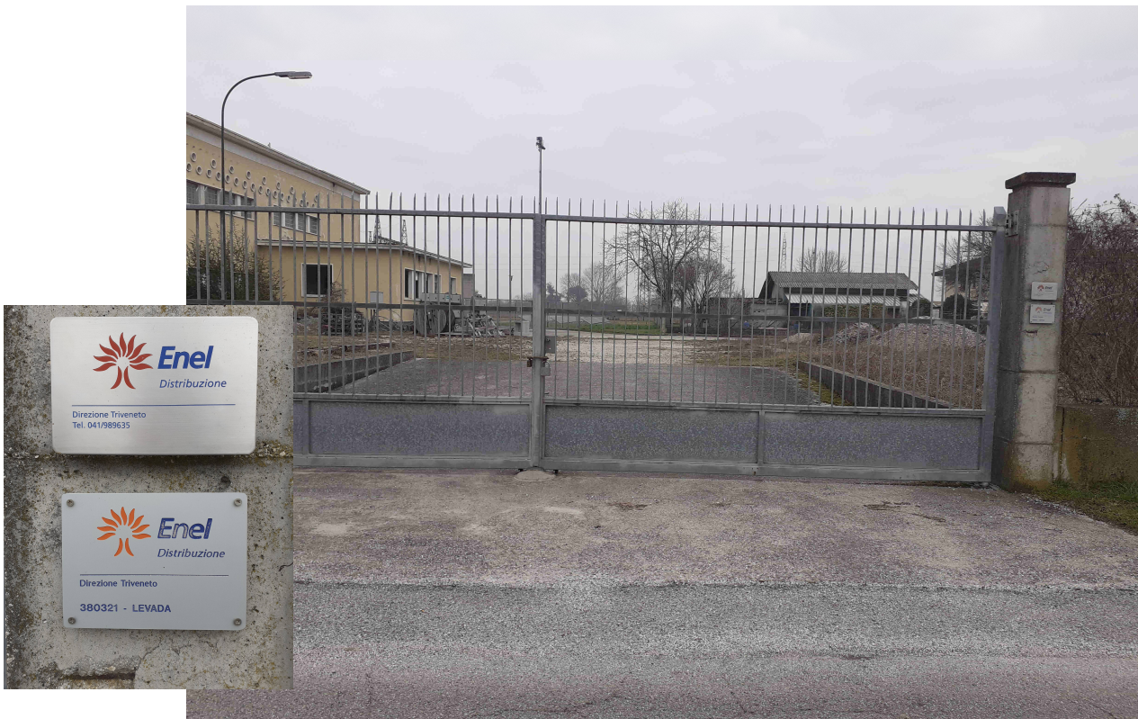
Fotografia 10 : Vista dell'ingresso alla Cabina Primaria "Levada" da Via Bassie
