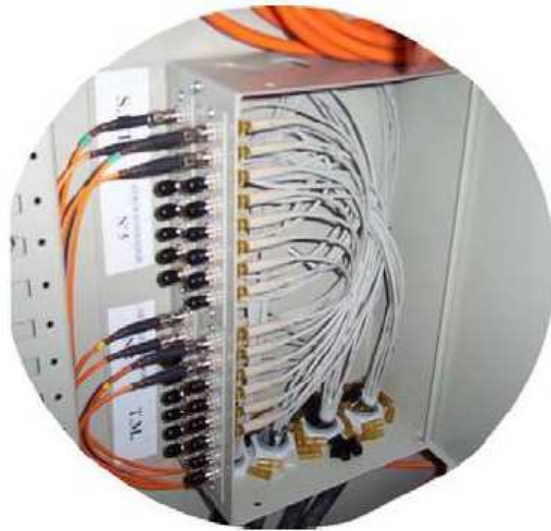
Figura 5 - Scatola di distribuzione per connessione fibre ottiche
