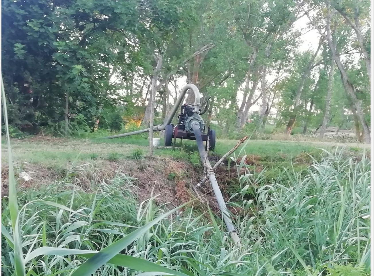
Figura 11 - FA-B-CH_PT01_F01 – Pompa per il prelievo di acqua nel canale in prossimità della stazione di ascolto
