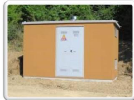
Cabina di sezionamento In Regione Bancali
