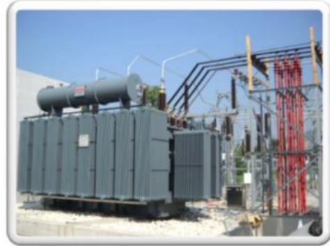
Trasformatore MT/AT 30/150kV (30/36 kV) 60 MVA
