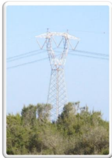
Traliccio AAT 380kV " FIUMESANTO CARBO – ITTIRI" Presso sito previsto per nuova stazione AAA/AT TICA n. 202002125
