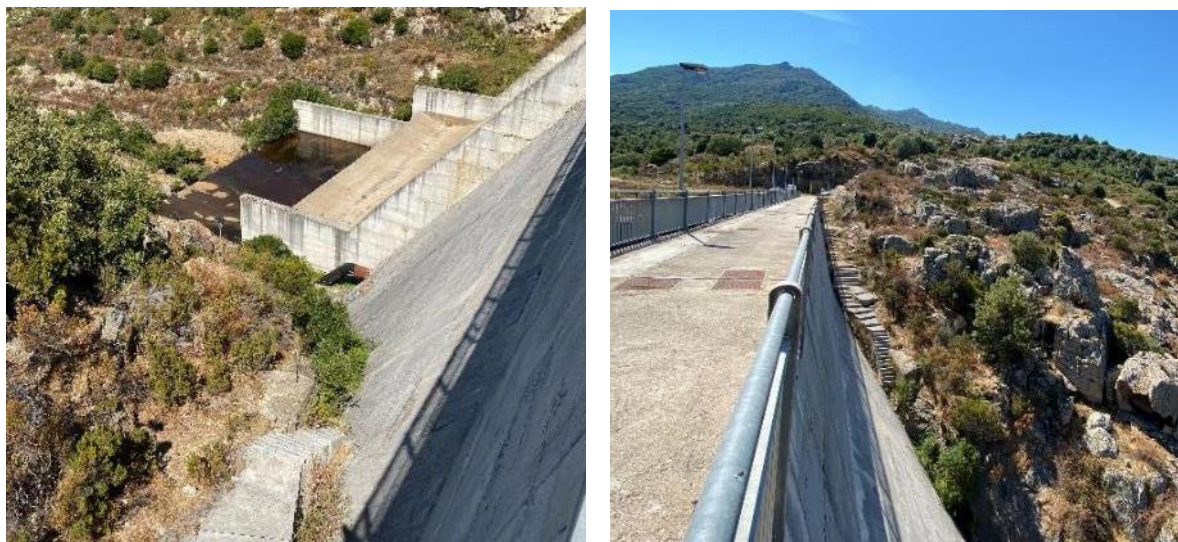
Figura 18 - Viste della scala di accesso in sponda sx non terminata
