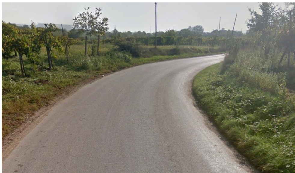
Figura 8: sede stradale attuale - carenza di protezioni marginali
