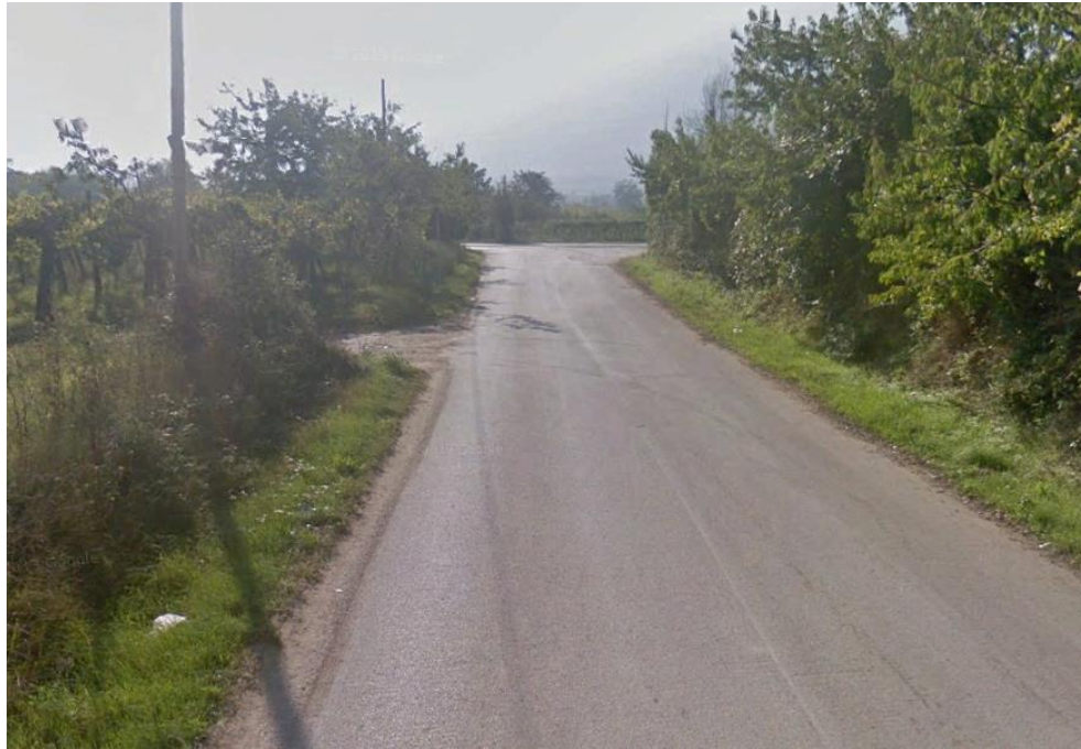
Figura 9: sede stradale attuale - assenza di banchine laterali
