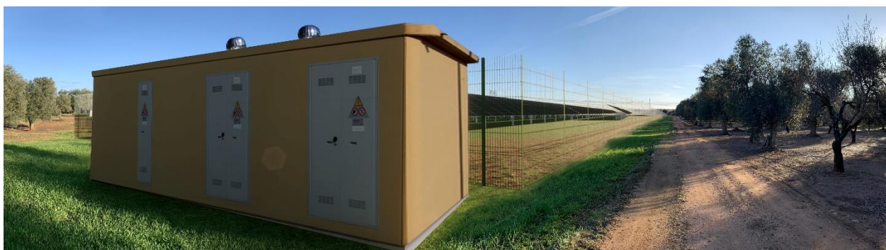
Area Nord-Ovest di impianto – post operam
