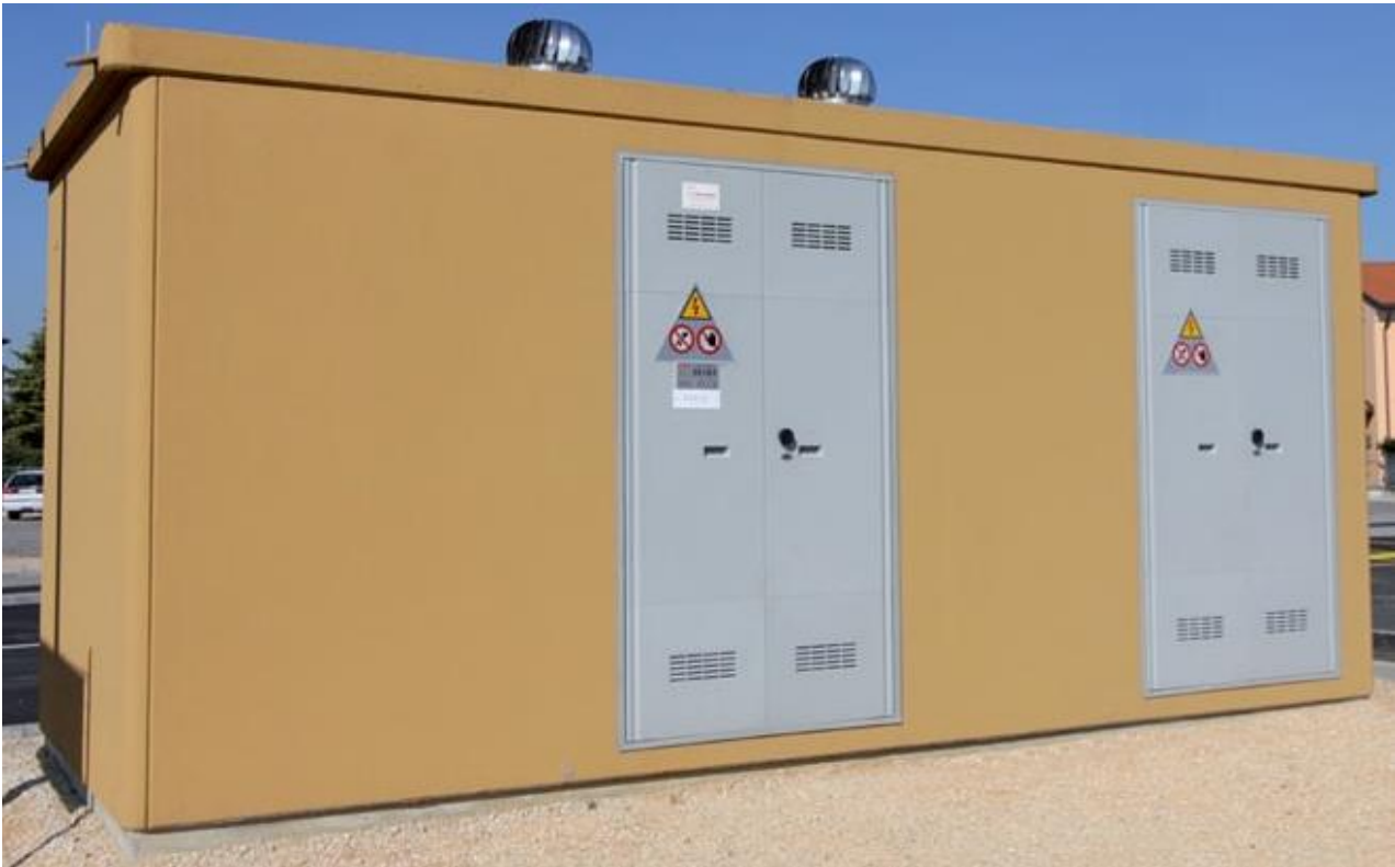
Figura 13 – Vista frontale cabina di trasformazione
