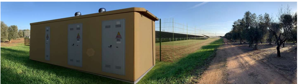
Area Nord-Ovest di impianto – post operam
