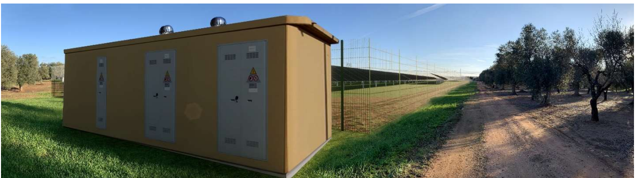
Area Nord-Ovest di impianto – post operam
