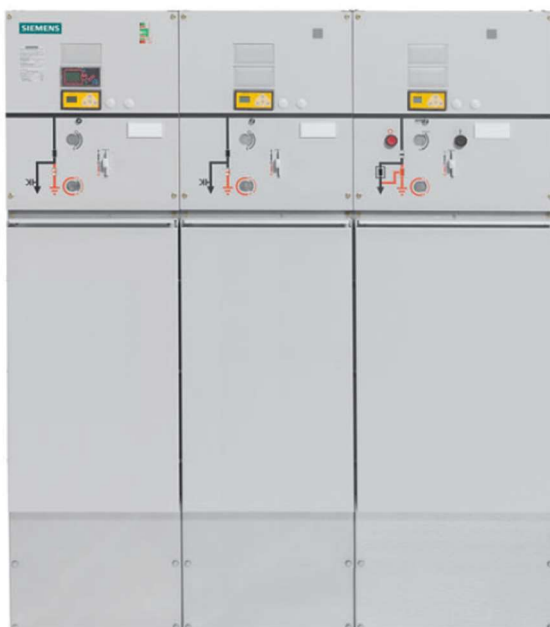
Figura 12 – Vista frontale quadro di protezione in media tensione della cabina di trasformazione
