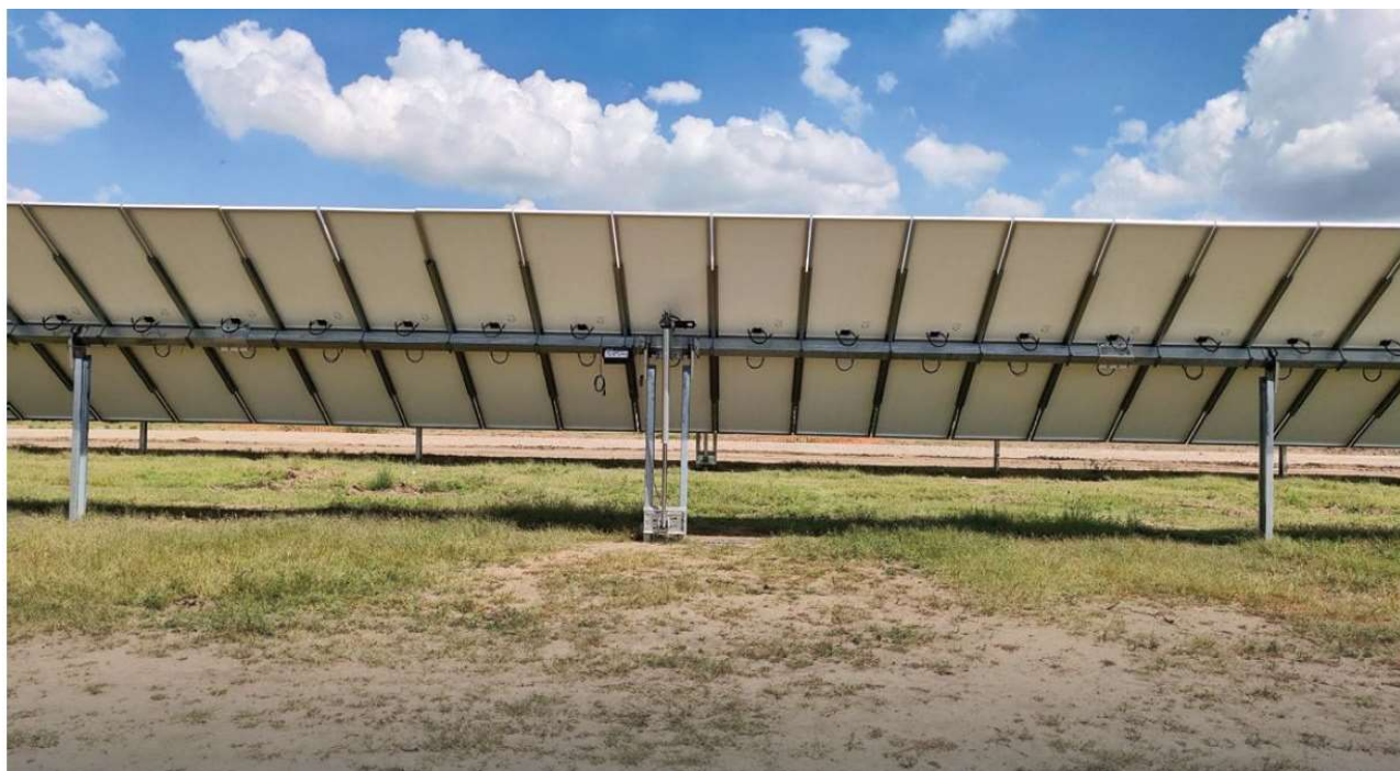
Figura 36 - Inseguitore monassiale vista posteriore
