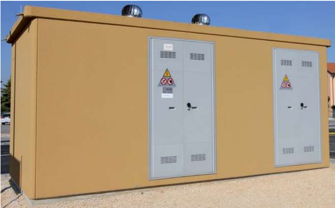
Figura 31 – Vista frontale cabina di trasformazione
