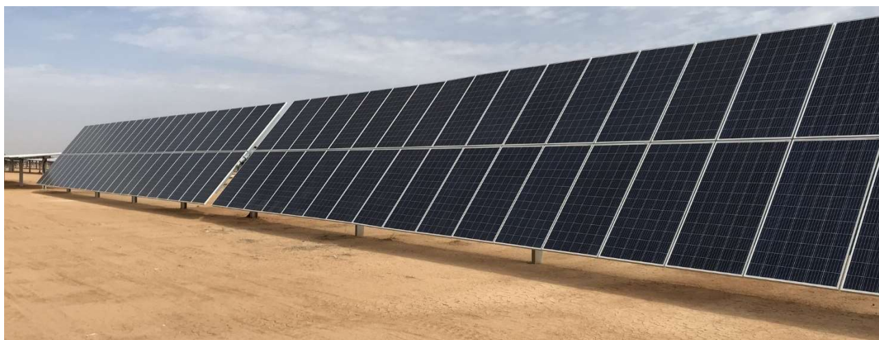
Figura 35 - Inseguitore monoassiale vista frontale
