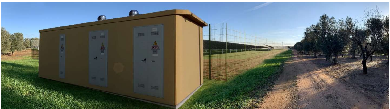
Area Nord-Ovest di impianto – post operam
