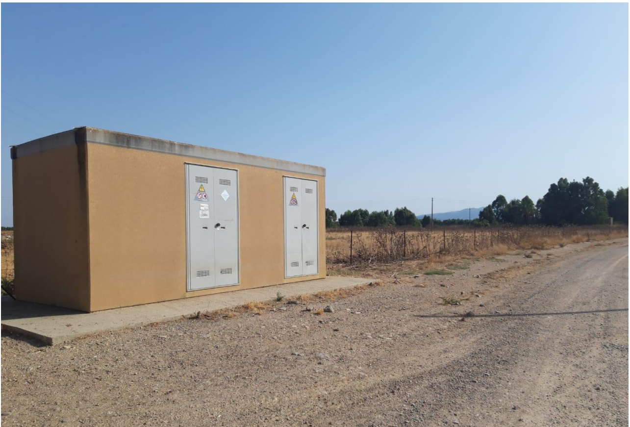
Figura 34: Cabine di trasformazione su stradello.
