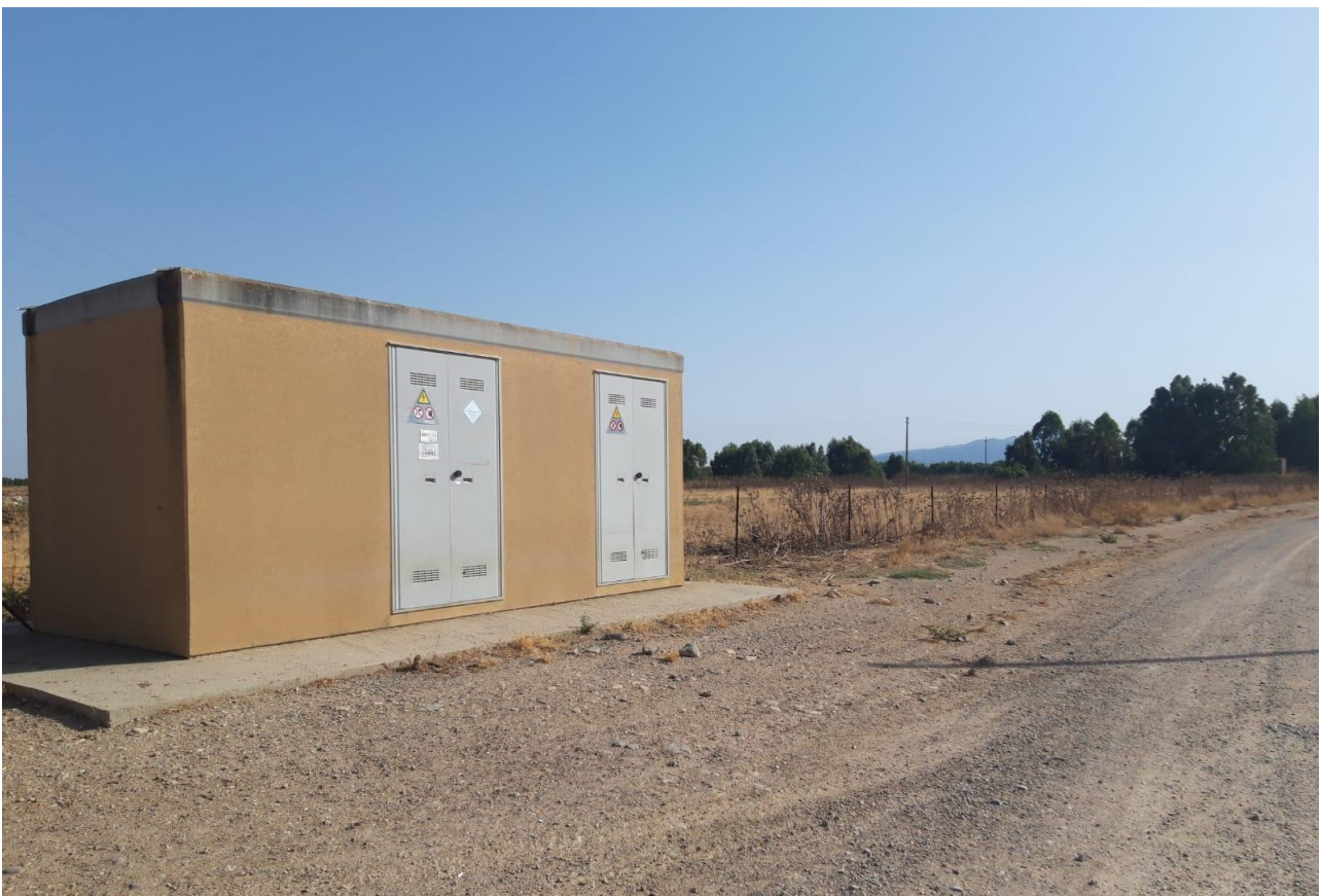
Figura 35: Cabine di trasformazione su stradello.
