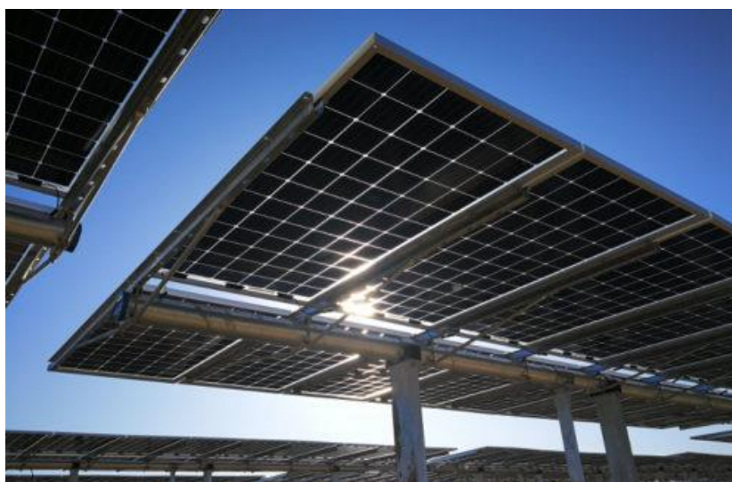
Figura 2.8 Esempio di struttura a tracker monoassiale.
