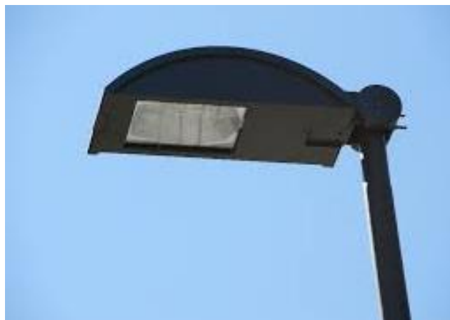
Figura 4.2: Esempio di apparecchio completamente schermato (full-cut-off).
