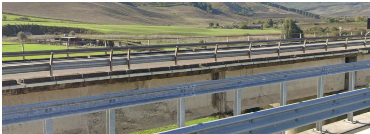
Figura 3.1. Canaletta in VTR ancorata al cordolo lato interno per l'intero sviluppo del viadotto (vista dalla carreggiata CT-PA)
