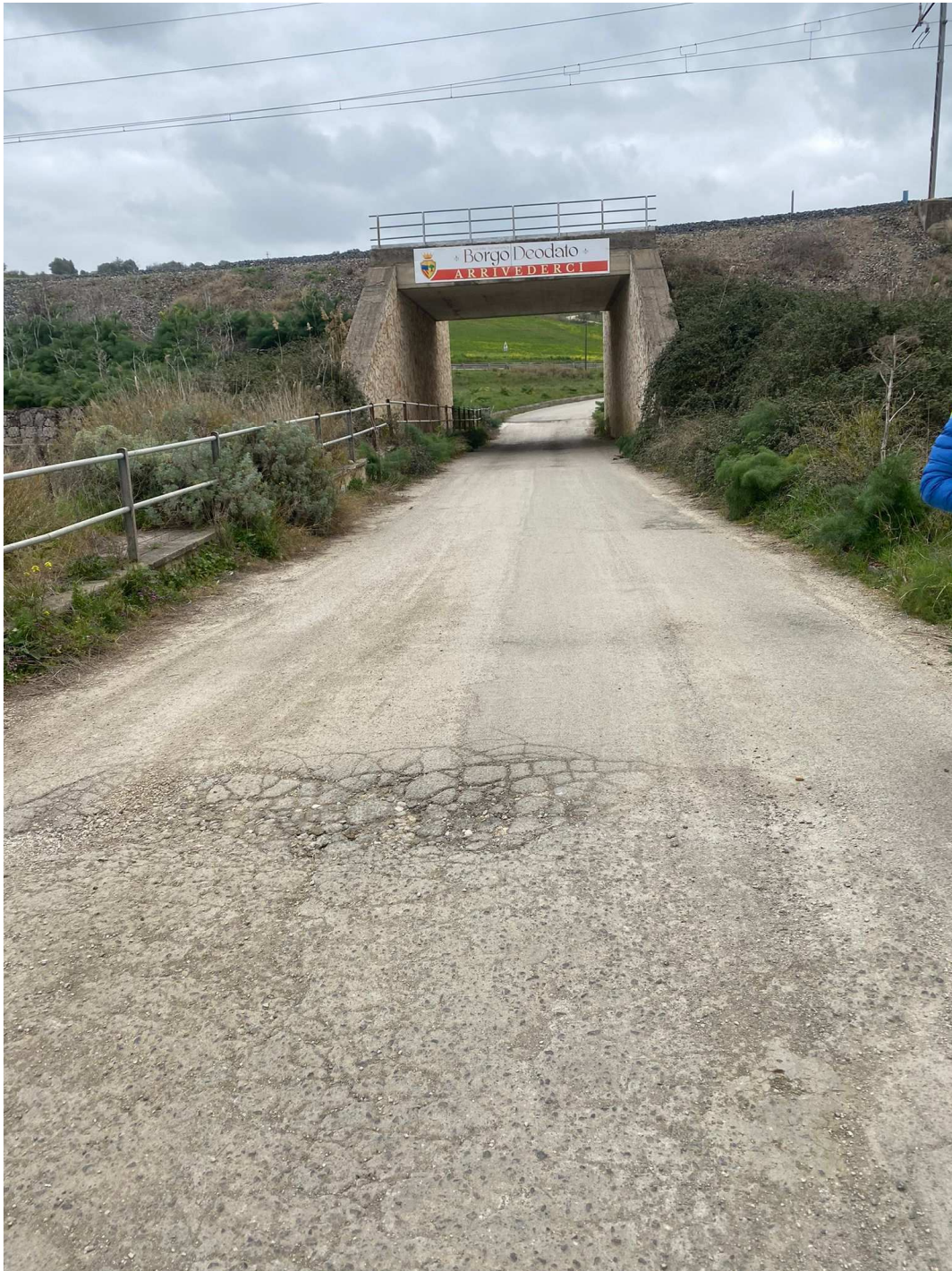
FOTO N. 10 Strada di cantiere esistente ed asfaltata su cui non sarà necessario prevedere opere di sistemazione ed adeguamento
