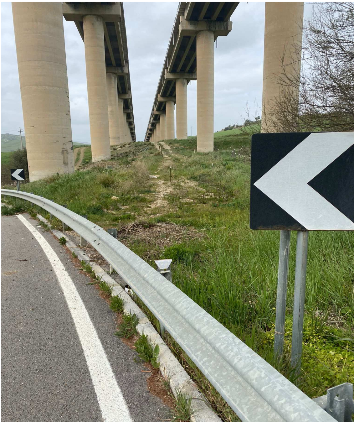
FOTO N. 2 - Da questo punto si utilizzerà sia la pista asfaltata che la vecchia pista di cantiere in terra battuta realizzata per la costruzione del viadotto negli anni sessanta. Come si vede l'attuale pista non necessita lavori di allargamento/sbancamento di nessun tipo poichè è perfettamente idonea. Le uniche opere da realizzare saranno quelle di una sistemazione e ripristino senza allargamenti e senza creare impatti di nessun tipo
