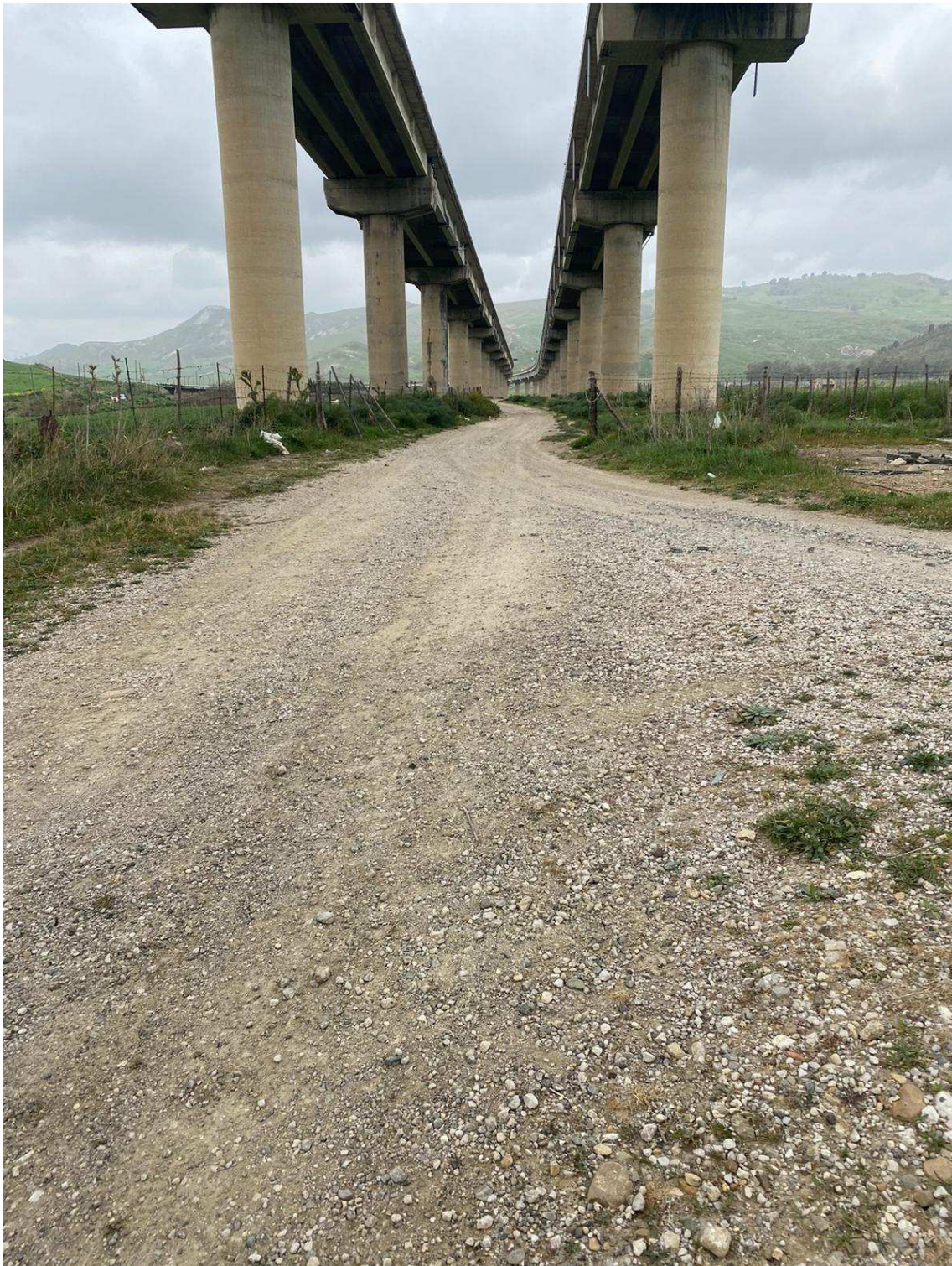
FOTO N. 13 Pista di cantiere esistente in terra battuta su cui non sarà necessario prevedere opere di sistemazione ed adeguamento
