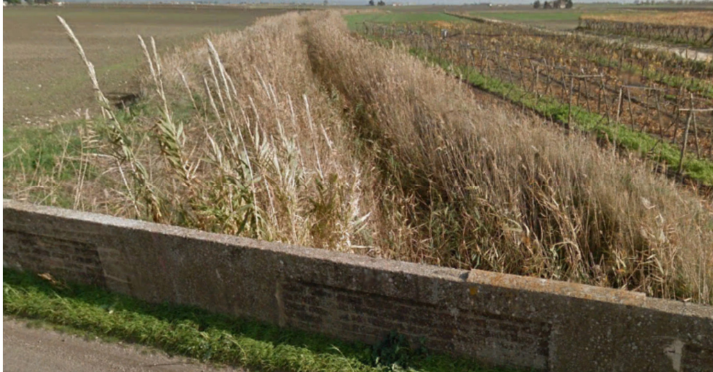
Figura 5.17: Interferenza P05, sezione C. S. Maria sovrappasso con SP20. Vista verso valle.
