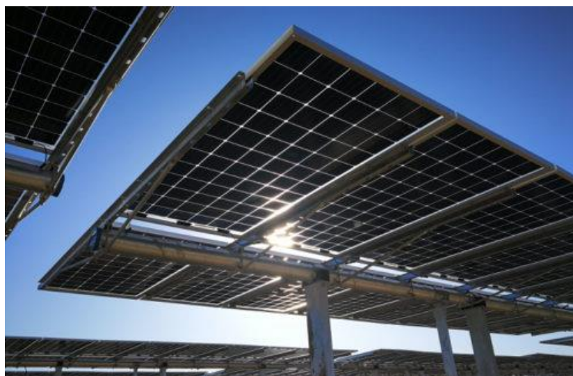
Figura 2.41 Esempio di struttura a tracker monoassiale
