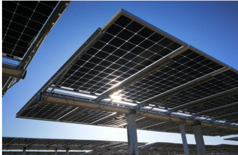
Figura 2.8 Esempio di struttura a tracker monoassiale
