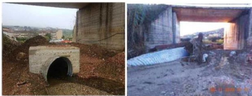
Figura 50 Danneggiamenti TP25 a seguito degli eventi alluvionali di Novembre 2018
