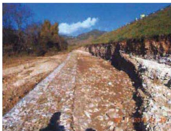
Figura 16 Danni alle gabbionate ed al piede del rilevato
