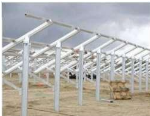
FIGURA 3 - STRUTTURE DI SOSTEGNO (TRACKER)
