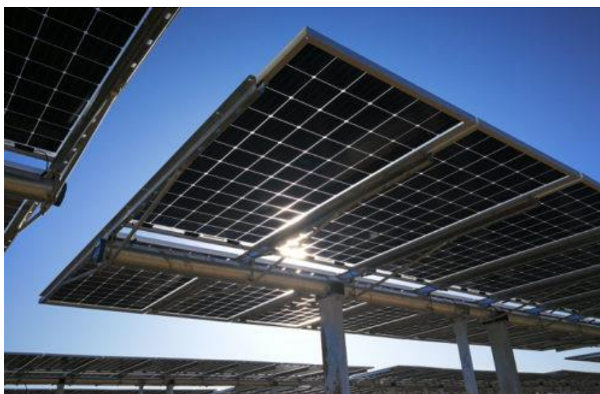
Figura 2.7 Esempio di struttura a tracker monoassiale
