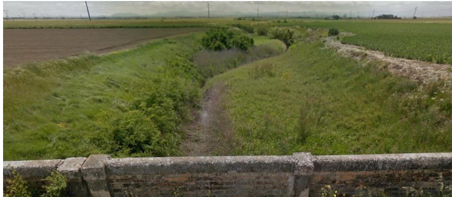
Figura 3.12: Sezione del torrente Celone in corrispondenza dell'attraversamento con via Napoli, nel territorio comunale di Foggia.
