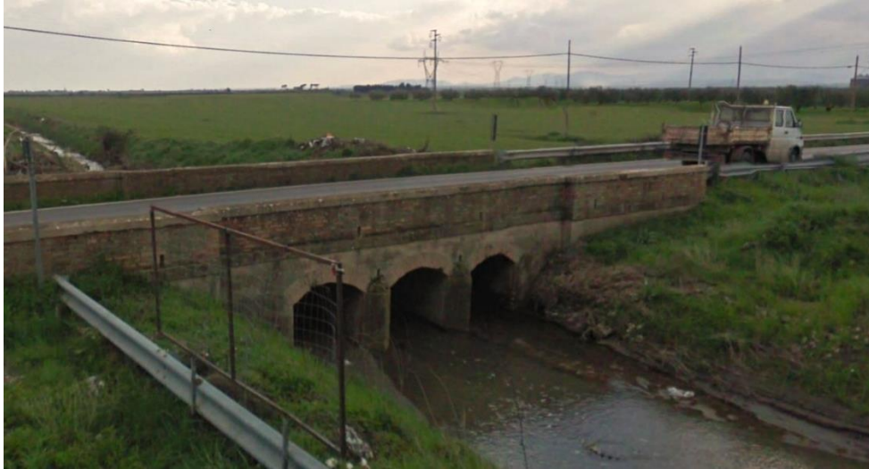
Figura 5.14: Sezione Fosso S. Giusta, sovrappasso sulla strada provinciale SP115, vista verso monte.
