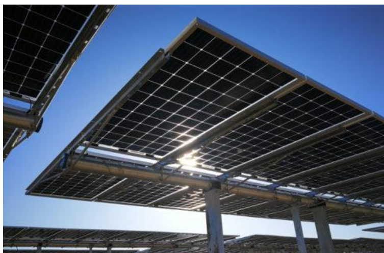
Figura 2.9 Esempio di struttura a tracker monoassiale
