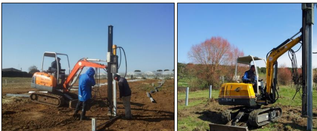
Figura 69 - Tipologia di installazione delle strutture di sostegno dei moduli FTV con macchina battipalo
