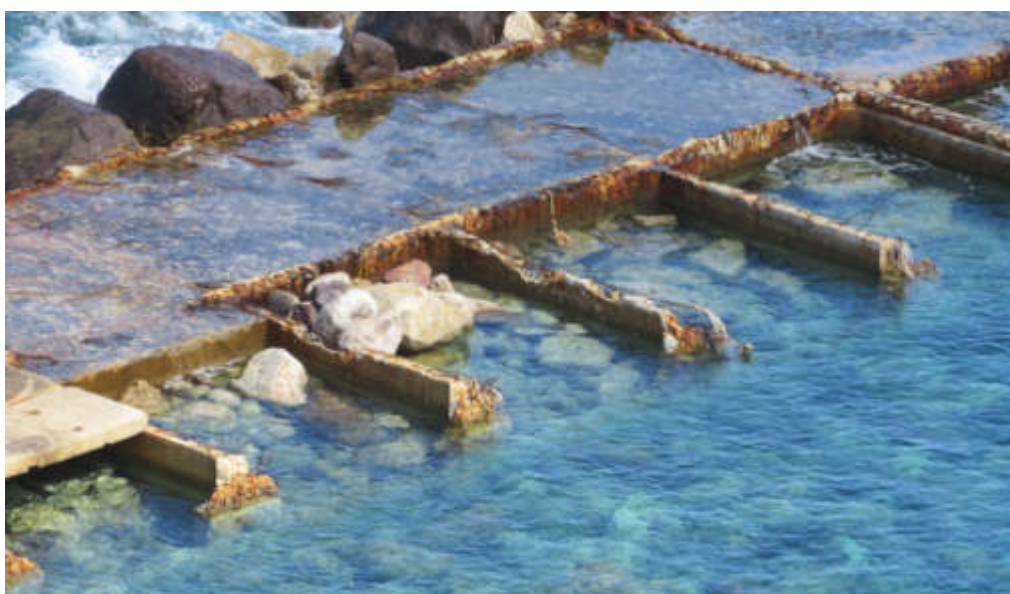
Figura 3: Particolare stato di danneggiamento dei setti interni ai cassoni
