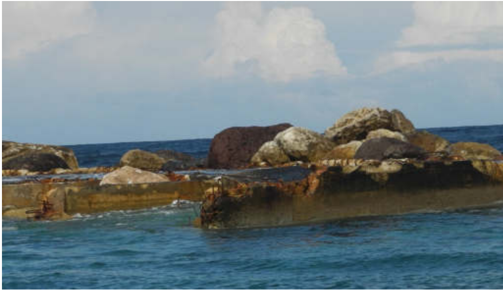
Figura 4: Particolare stato di danneggiamento delle pareti dei cassoni
