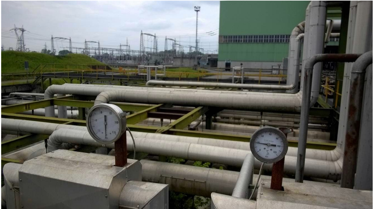
TETTOIA COMBUSTIBILI – ZONA TUBAZIONI DI INTERFACCIA CON SERBATOI STOCCAGGIO
