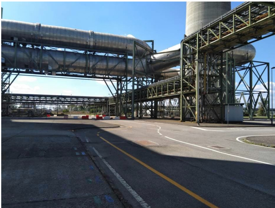
TRATTA DI PIPE RACK FINO AL BATTERY LIMIT IN ZONA CIMINIERA 8
