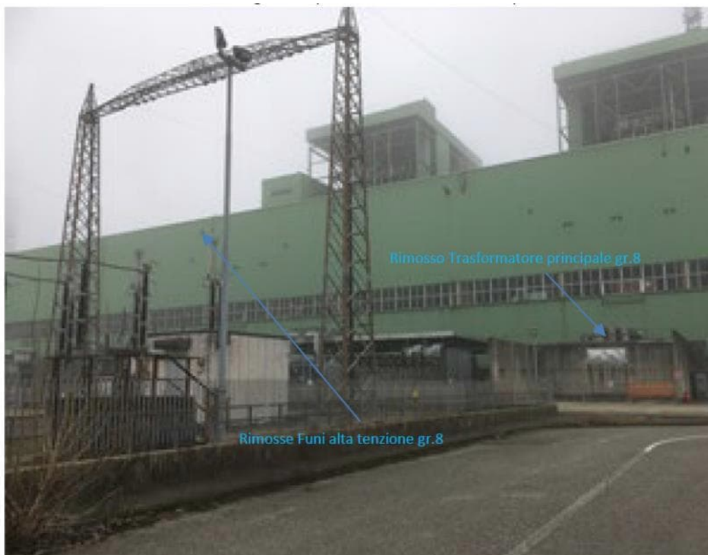
Figura 14: Trasformatore principale e funi in alta tensione asserviti al Gruppo 8 - Dopo la rimozione dei componenti
