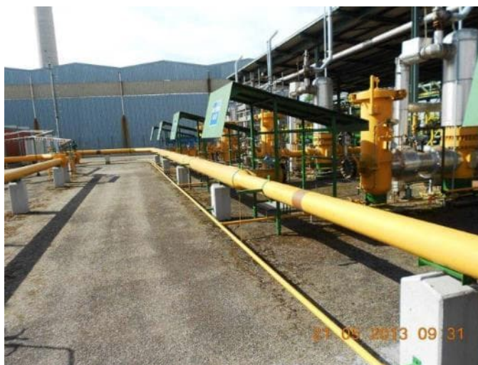
Figura 5: Vista collettore principale
