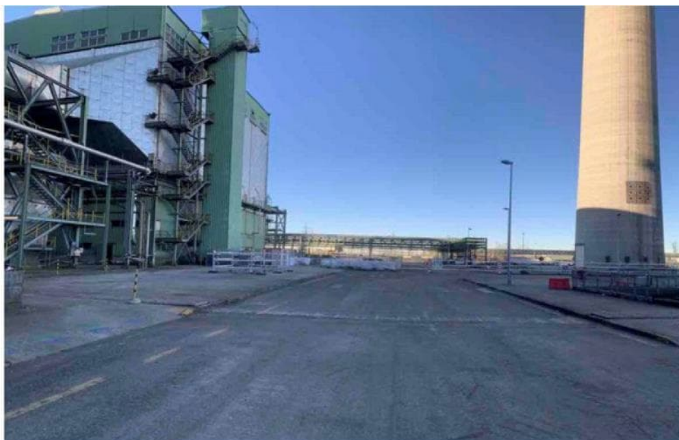
Figura 12: Pipe rack zona adiacente al Gruppo 8 - Dopo la demolizione del pipe rack
