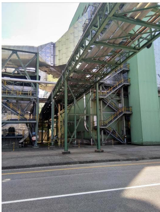
TRATTA DI PIPE RACK FINO AL BATTERY LIMIT IN ZONA CIMINIERA 8
