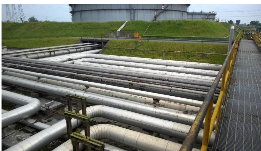
Figura 25: Tubazioni da parco nord al limite della tettoia.
