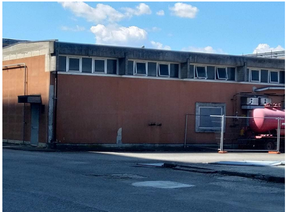
ESTERNI CABINA SCHIUMOGENO
