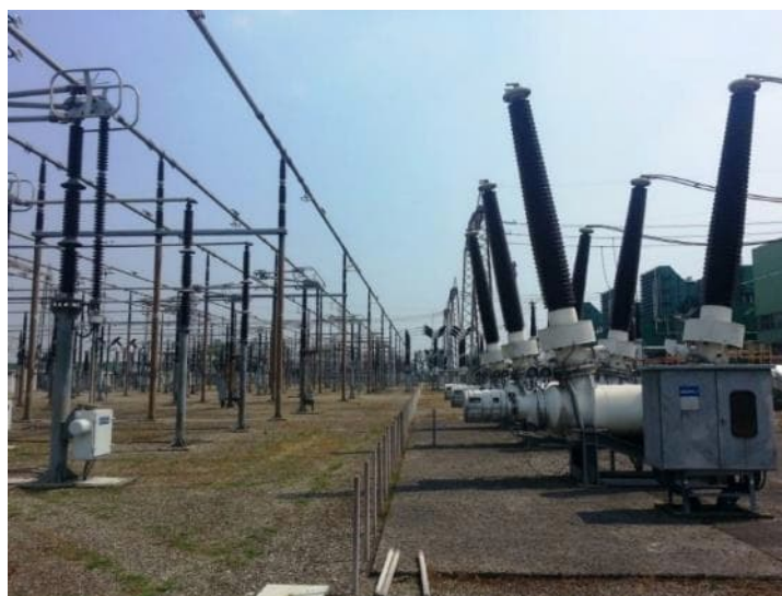
Figura 9: Vista interruttore di macchina Gruppo 7 – Tolto il conduttore
