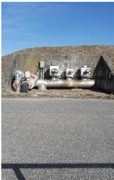
Figura 14: Limite di batteria – Valvola manuale tubazioni antincendio dei serbatoi.
