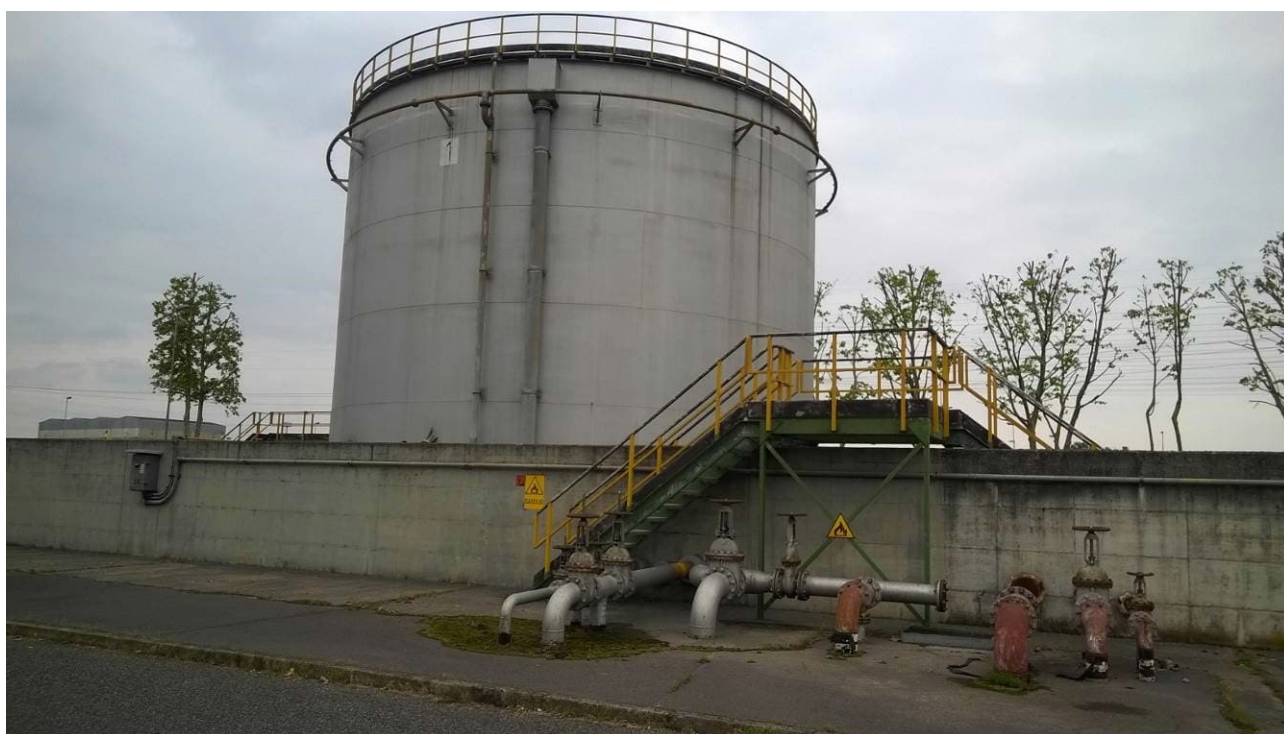
SERBATOIO STOCCAGGIO GASOLIO E BACINO DI CONTENIMENTO
