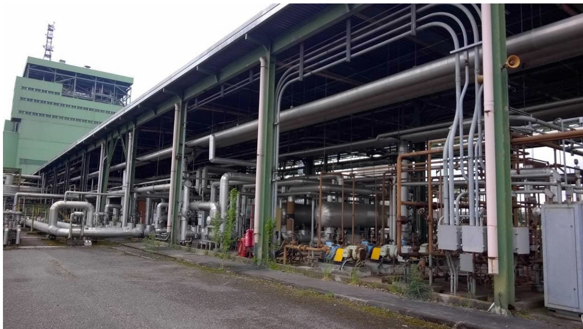
TETTOIA POMPE/RISCALDATORI ADIACENTE AL PARCO NORD [IN PRIMO PIANO AREA GASOLIO]
