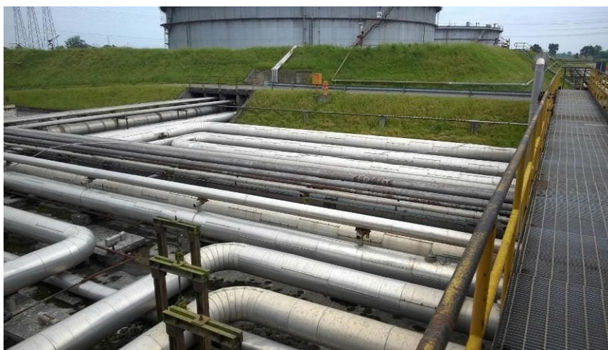
TUBAZIONI DA PARCO NORD AL LIMITE DELLA TETTOIA
