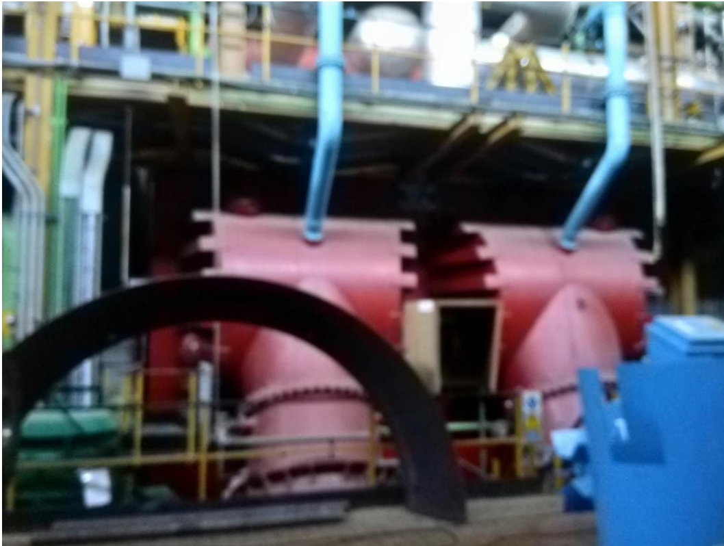
CASSE ACQUA CONDENSATORE UNITÀ 8 – LATO INGRESSO
