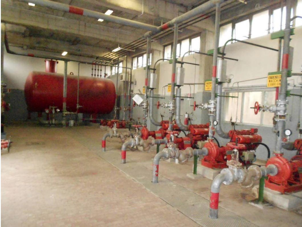
INTERNI CABINA SCHIUMOGENO
