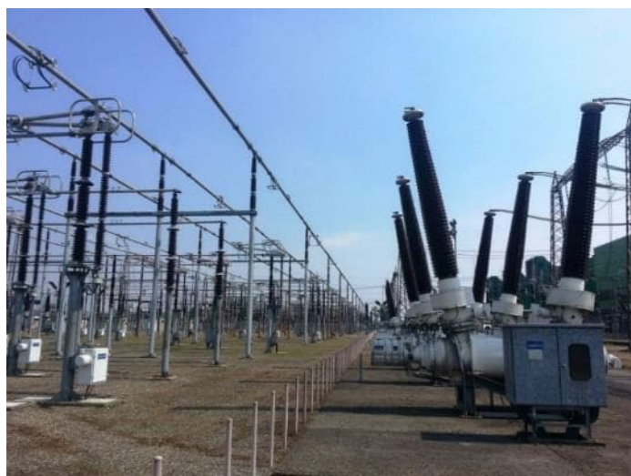
Figura 10: Vista interruttore di macchina Gruppo 8 – Tolto il conduttore
