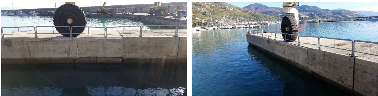
Figura 9-17 Cedimento via di corsa travel lift
