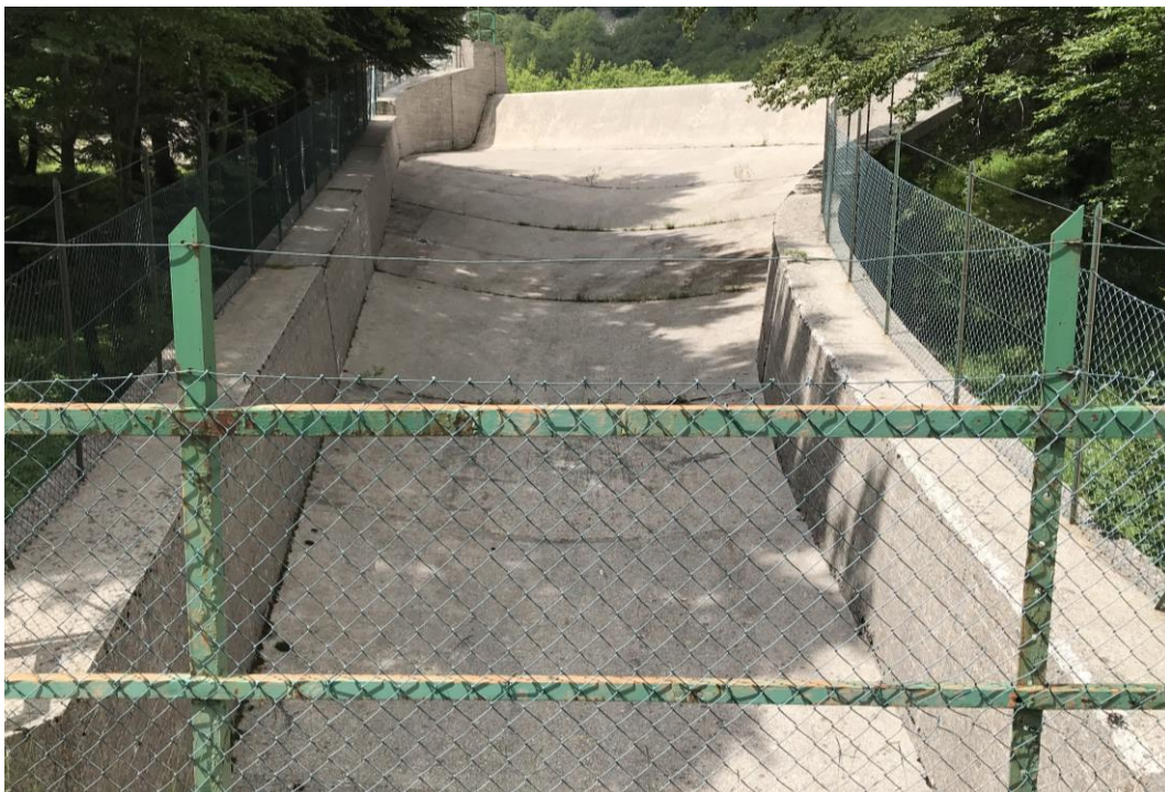
Figura 3.16 In alto la soglia dello scarico di superficie. In basso il canale fuggatore dello scarico di superficie
