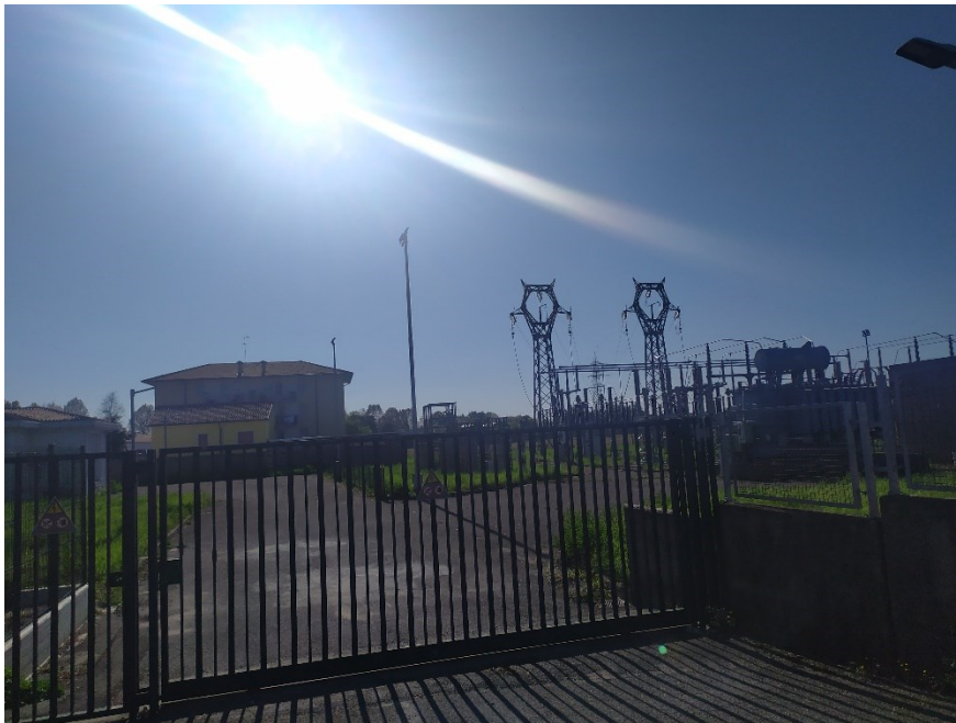
Foto 23 – SR252 – Ingresso cabina primaria “Palmanova”
