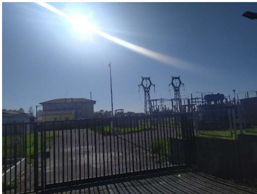
Foto 23 bis – Particolare Ingresso cabina primaria "Palmanova"
