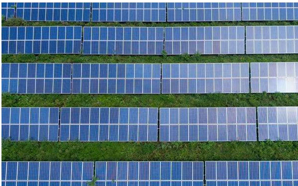
Immagine di un impianto agri-voltaico
