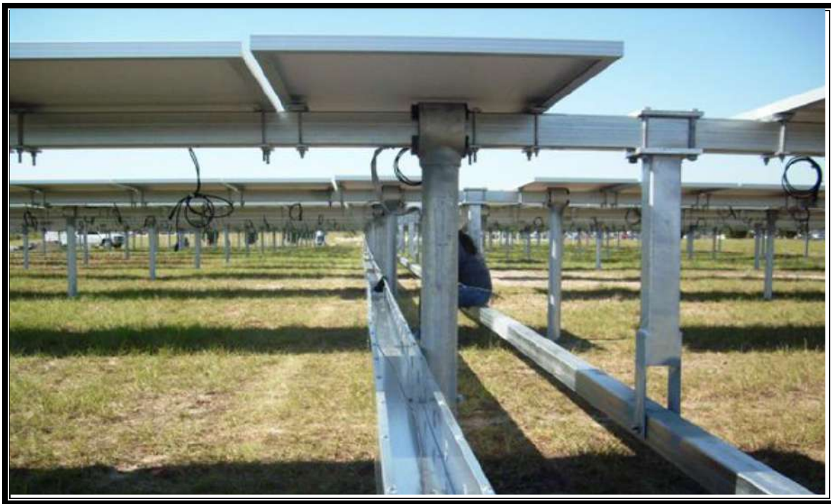
Figura 51 - VISTA DELLE STRUTTURE AD INSEGUIMENTO MONOASSIALE
