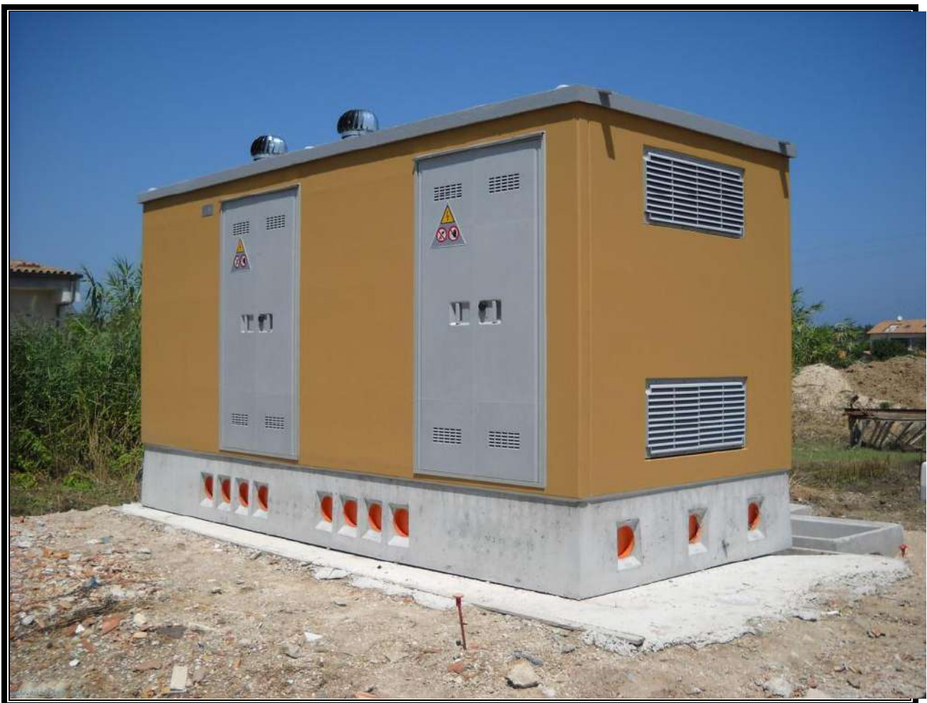
Figura 13 - ESEMPIO DI CABINA DI PARALLELO MT
