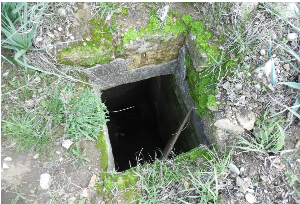
Figura 10: pozzetto in prossimità dell'acquedotto
