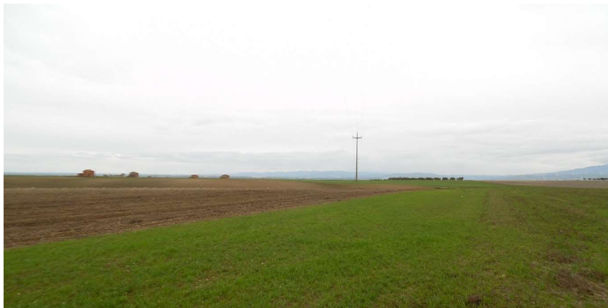
Figura 7: Linea di MT a sud est dell'impianto
