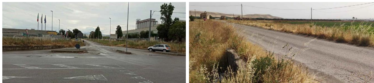
Figura 9 Stato dei luoghi area di intervento 5 (fonte: Relazione sulla risoluzione delle interferenze) e Stato dei luoghi area di intervento 6 (fonte: Relazione sulla risoluzione delle interferenze)
