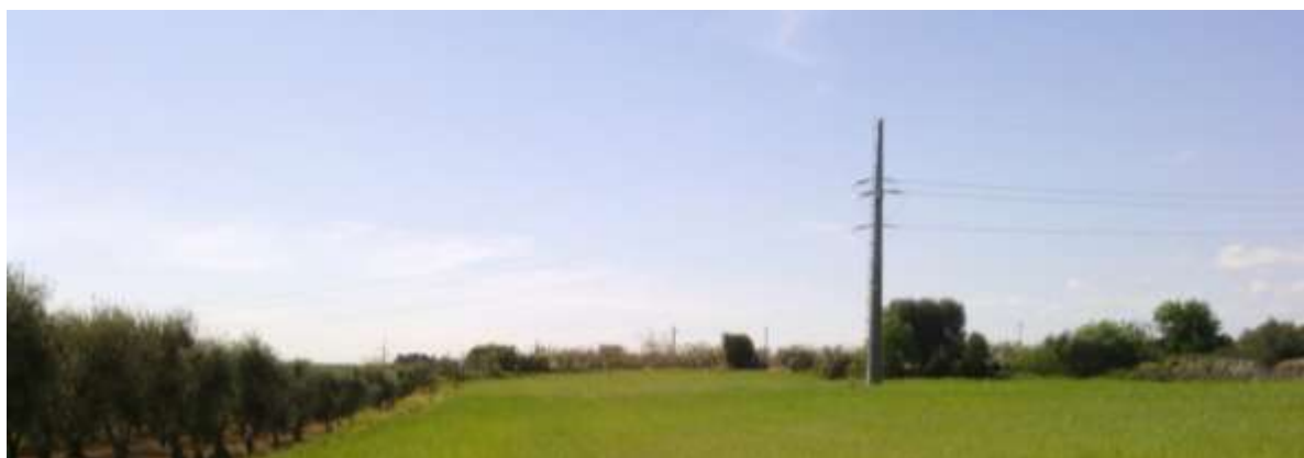
Figura 6: Linea di MT a nord dell'impianto – vista verso nord est.
