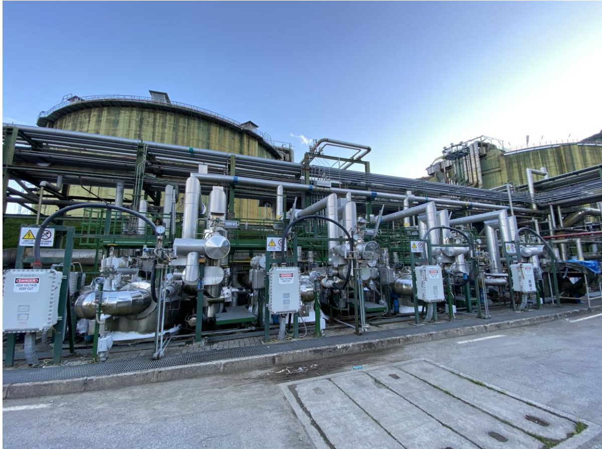
Foto 12: Zona pompe P101
