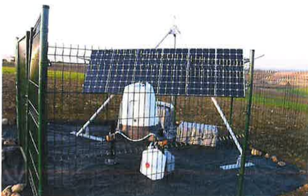
Vista complessiva da Sud dell'installazione esterna
