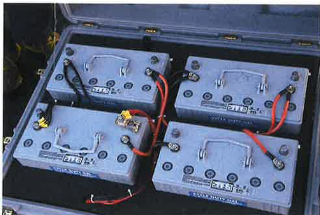
Dettaglio contenitore batterie aggiuntive
